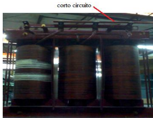
Figura 4.17 Corto circuito de la conexión estrella en baja tensión de transformador.
